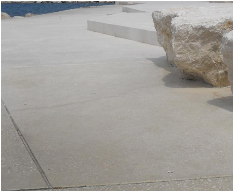
Slika 7.13. Pukotina na plaži Monte Mulini
