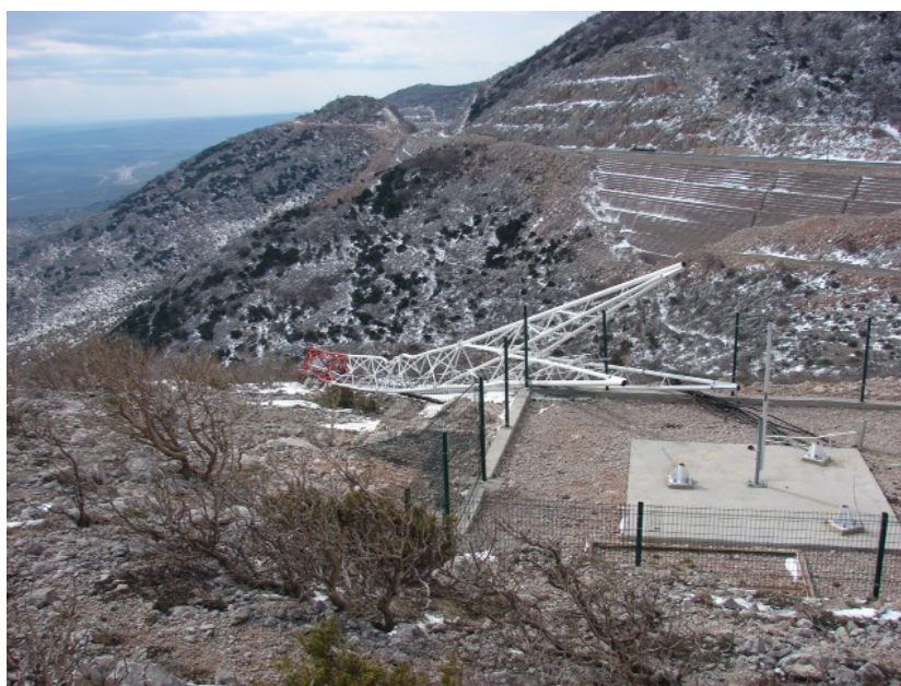
Slika 5.1 Srušeni antenski stup, Marune (južna padina Velebita, 2013)
