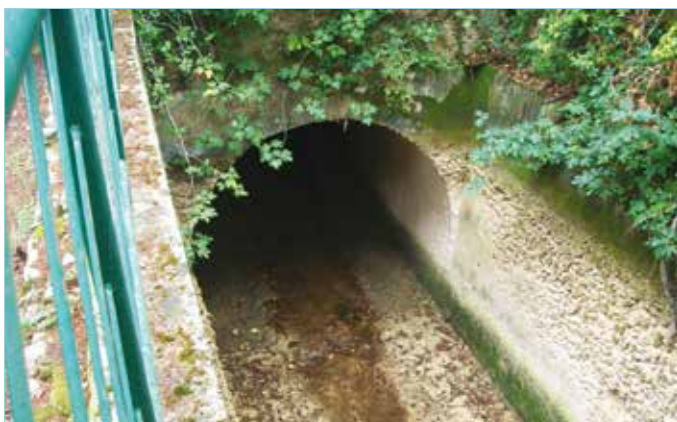
Slika 9: Dovodni tunel i kanal za HE Jaruga snimljeni 6. listopada 2015. U trenutku HE Jaruga nije radila (snimila: T. Roje-Bonacci)
