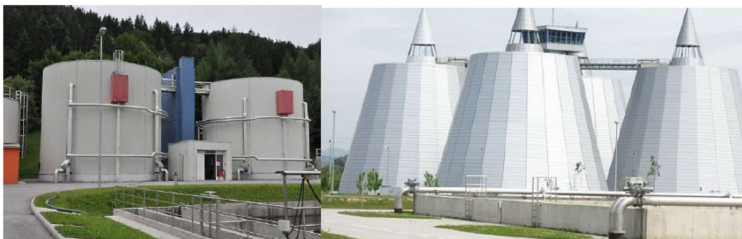
Slika 6.7. Složeni oblik digestora
