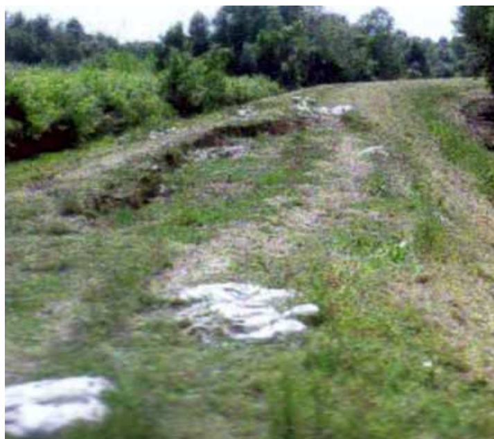
Slika 9.11 Pukotina u kruni nasipa, početak klizanja
