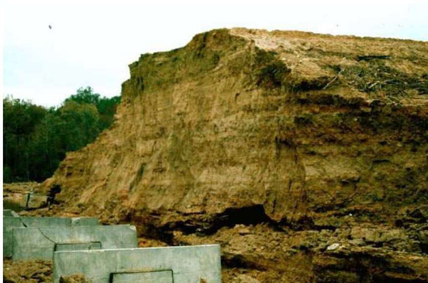
Slika 8.24 Prolom nasipa pri prvom punjenju (FEMA 2005.)
