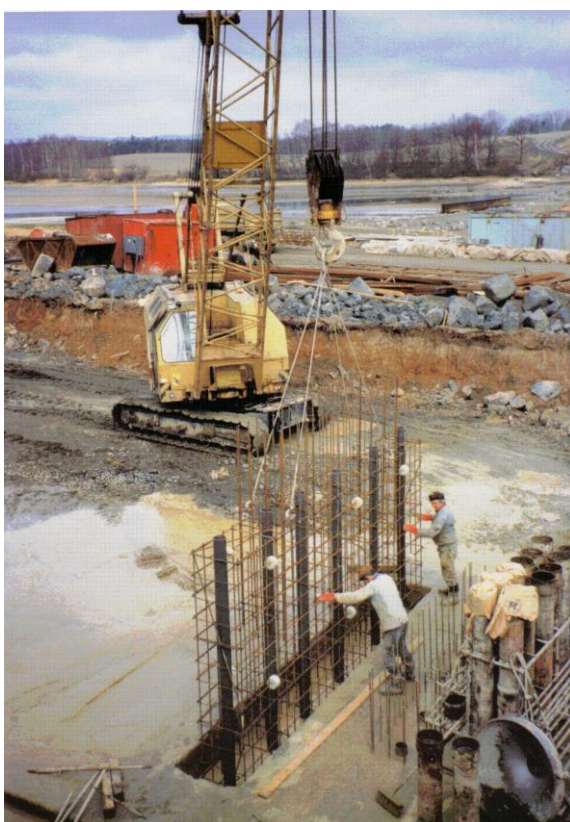
Slika 5.43 Ugradnja armature i cijevi za naknadno injektiranje ispod zagatne stijenke (Zakladani staveb, 1999.)
