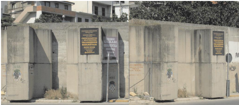
Slika 3.9 Betonski blokovi kao podupore nestabilnom konzolnom zidu (dokumentacija autora)
