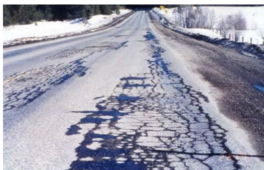
Slika 7.1 Oštećenja kolnika nakon otapanja leća leda
