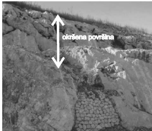
Slika 8.2 Okršena površina tla – usjek sa saniranim dijelom kaverne u nožici
