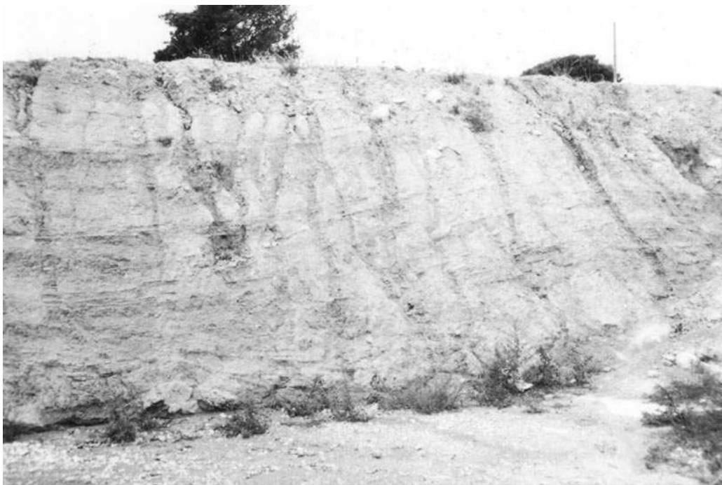
Slika 14.1 Usjek u flišu ostavljen duže vremena bez zaštite, vidi se učinak oborinske vode (Mišćević)
