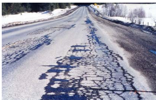
Slika 7.1 Oštećenja kolnika nakon otapanja leća leda
