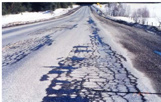
Slika 7.1 Oštećenja kolnika nakon otapanja leća leda
