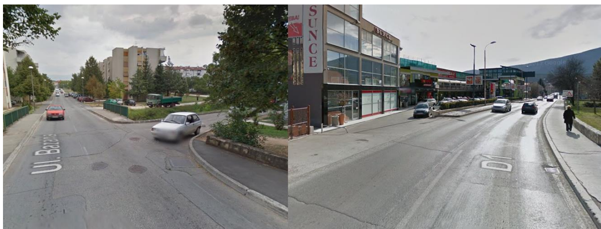
Slika 40. Primjeri lošeg stanja dijelova prometne infrastrukture u gradu Sinju [2]
