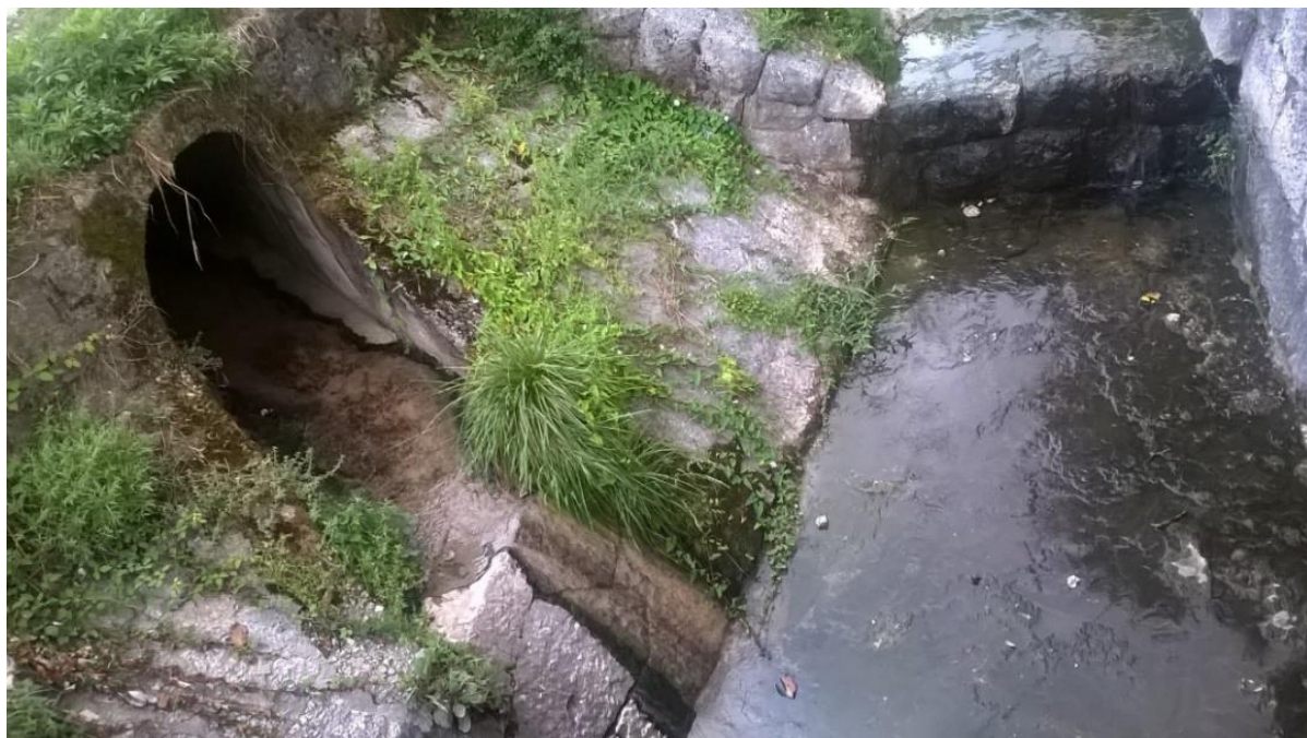
Slika 10. Ispuštanje ilegalnih priključaka u „Ćosin potok“
