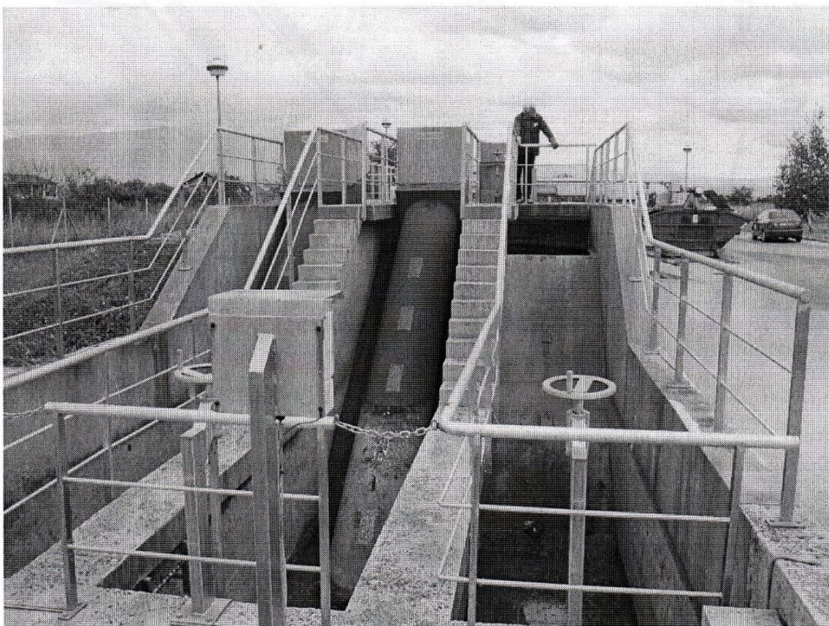
Slika 5. Uređaj za pročišćavanje otpadnih voda grada Sinja
