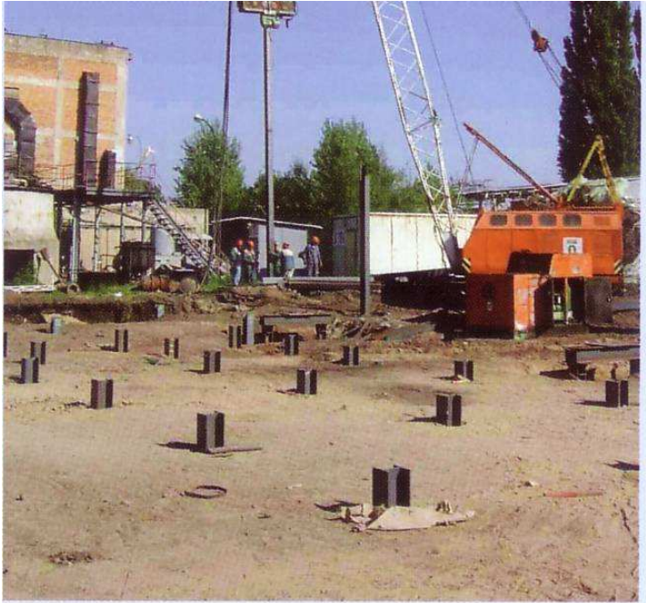
Slika 8.15 Glave mikropilota od čeličnih I profila, (u pozadini se vidi stroj za zabijanje pilota)
