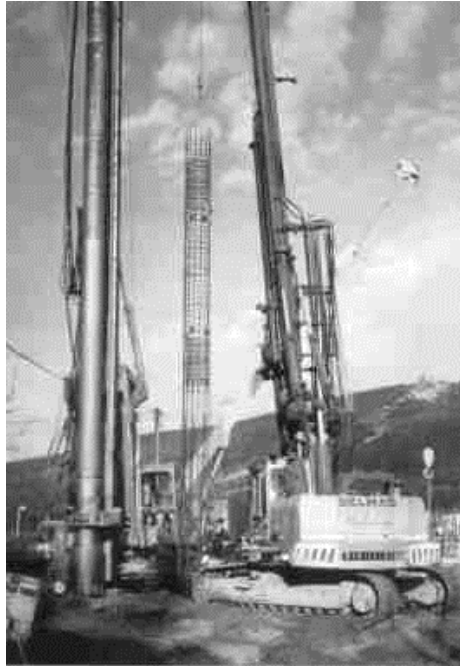
Slika 5.74 Zaštitna cijev, s krunom na dnu, lijevo i koš spreman za ugradnju, u sredini
