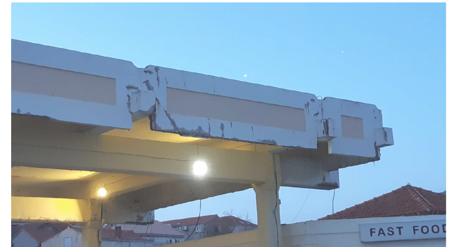
_loše stanje postojeće strehe kolodvora
