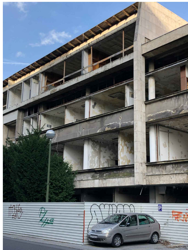
▲ ZATEČENO STANJE ZAPADNE FASADE
