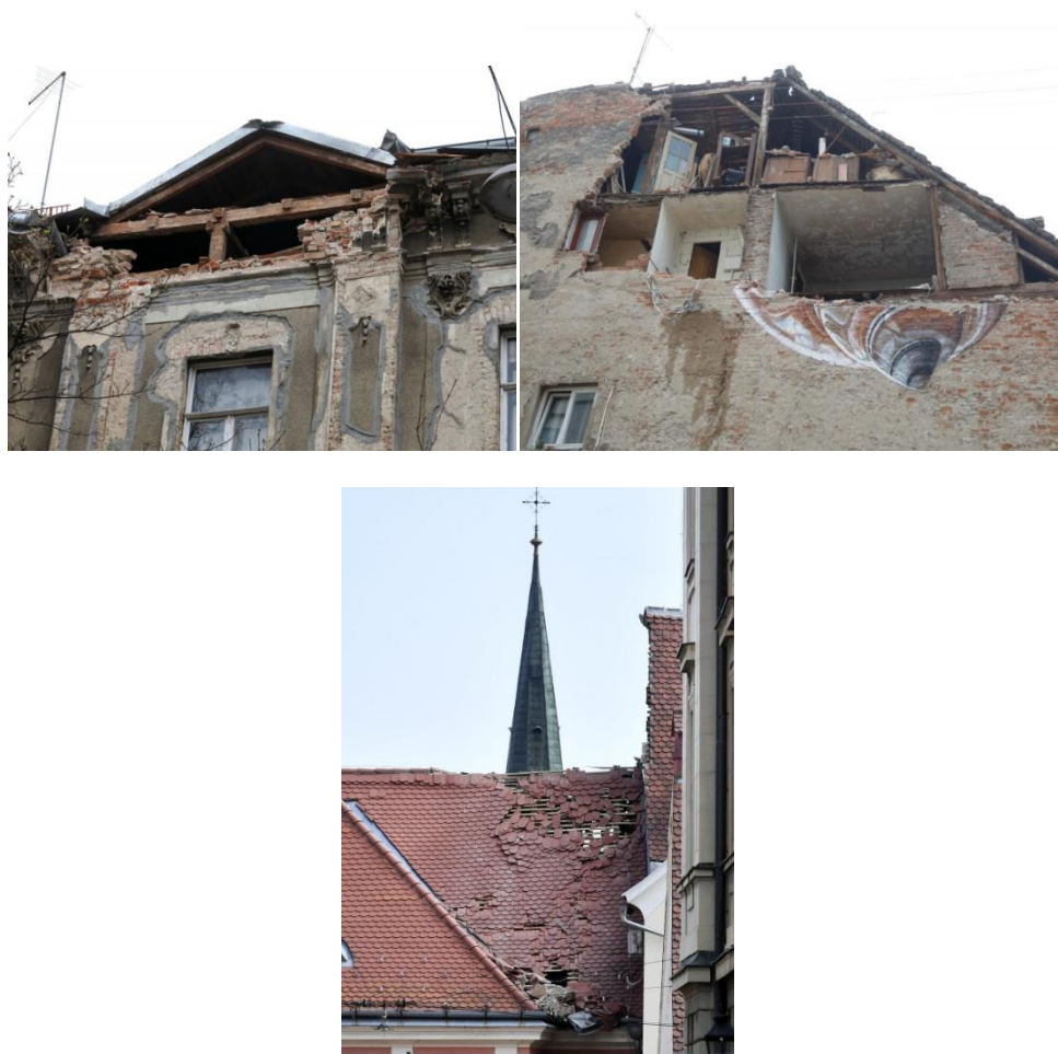
Slika 1. Utjecaj potresnih djelovanja na konstrukciju.
