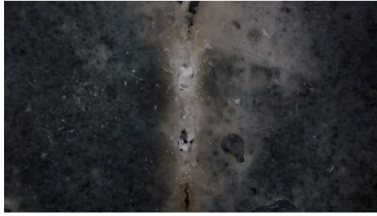
Slika 38. Stanje pukotine nakon 56 dana [86]
