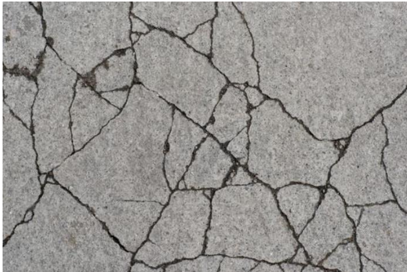
Slika 14. Prikaz pukotine u betonu [19]
