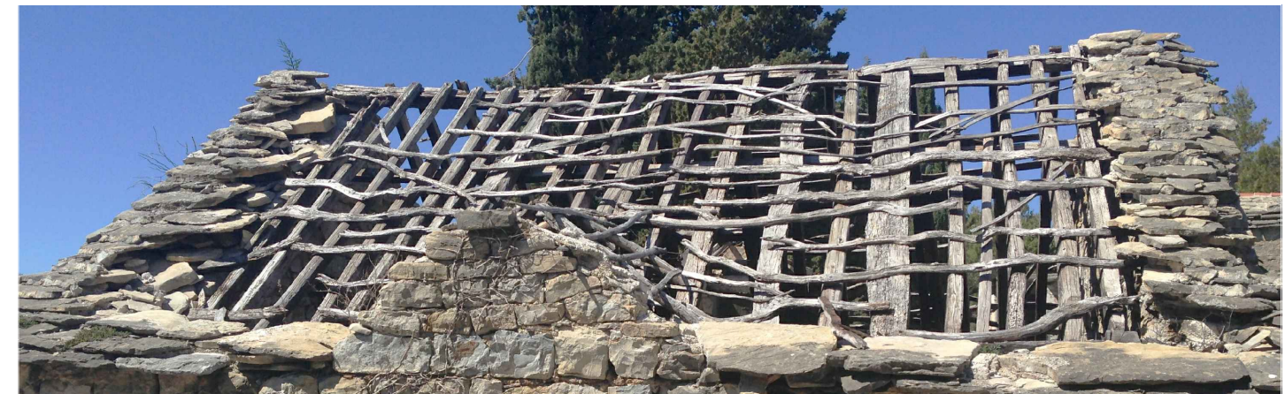
Grafički prilog 50. Primjer krovišta s dvostrukom strehom. Na razotkritom krovištu roženice su letvane neobrađenim granama čime se osigurava trenje i sprječava klizanje kamena, Tugare / fotografije autora analize
