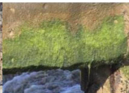
Slika 2.6 Alge na betonu
