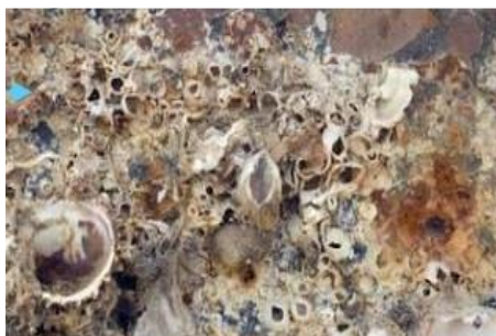
Slika 2.5 Školjke na betonu
