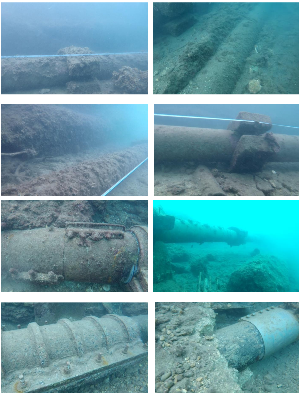
Slike 5. - 12. Prikaz lošeg stanja postojećeg cjevovoda
