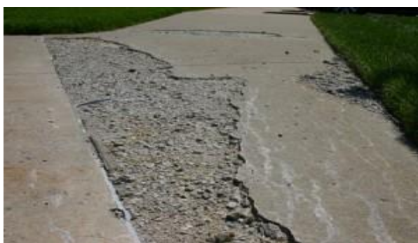
Slika 3.3 Oštećenje betona zbog smrzavanja [10]
