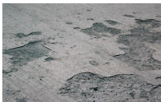
Slika 3.3 Oštećenje betona zbog smrzavanja [10]
