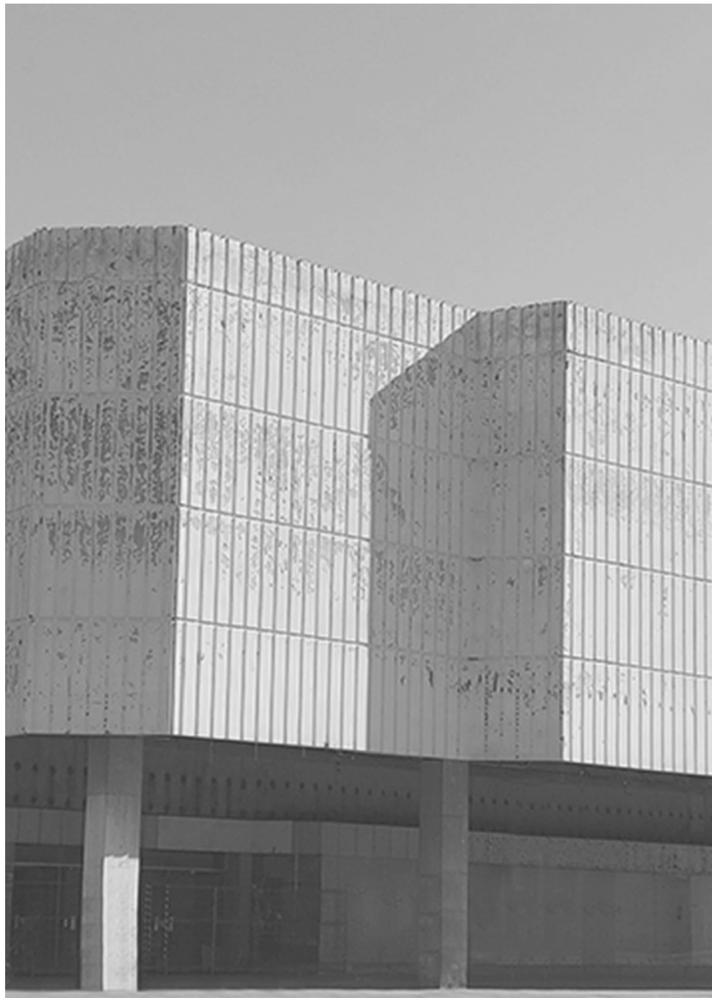
_detalj zatečenog stanja_2021. g
