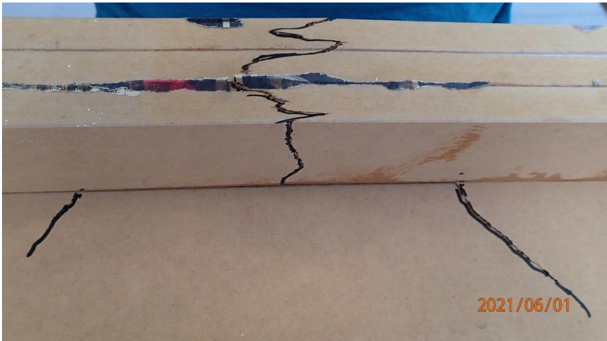
Slika 66: Pukotine s donje strane nosača
