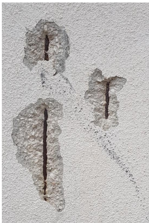
Slika 7. Ogoljena armatura na konstrukciji
