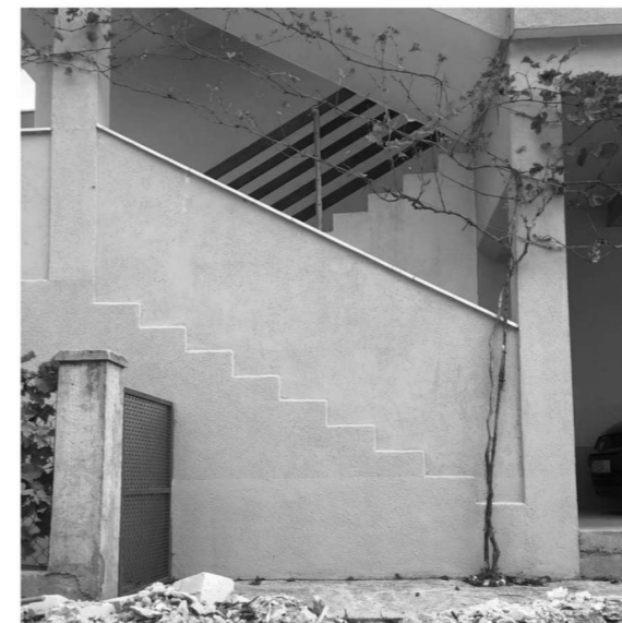
Nepotrebno naglašavanje gazišta stubišta
