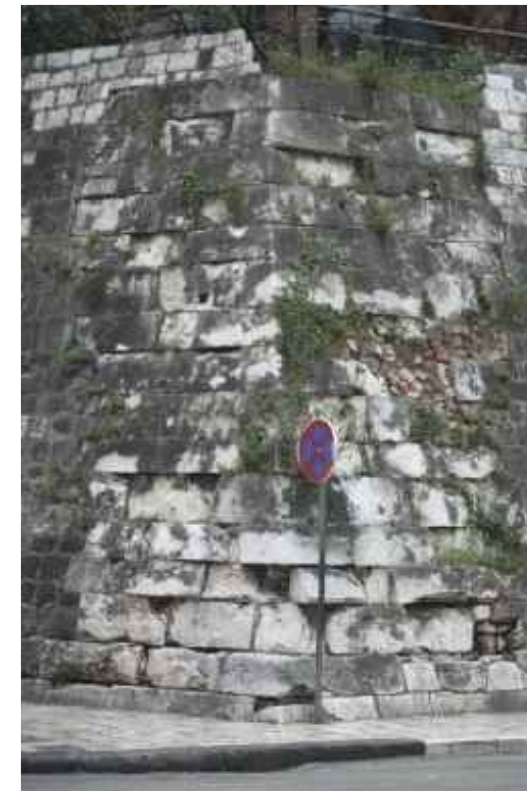
_29 Oštećenje lica bedema
