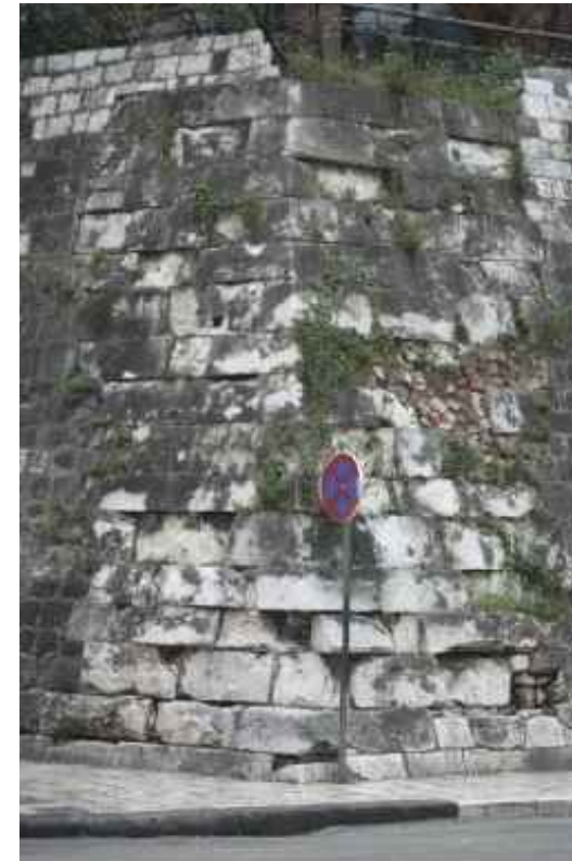
_29 Oštećenje lica bedema
