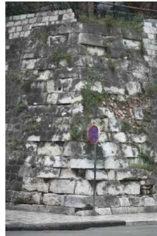
_29 Oštećenje lica bedema
