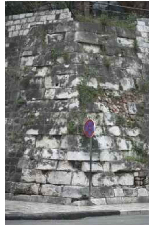
_29 Oštećenje lica bedema
