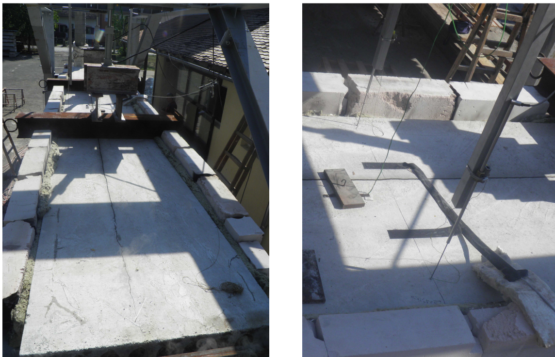
Fotografija 6.10. Prikaz uzdužne pukotine na ploči
