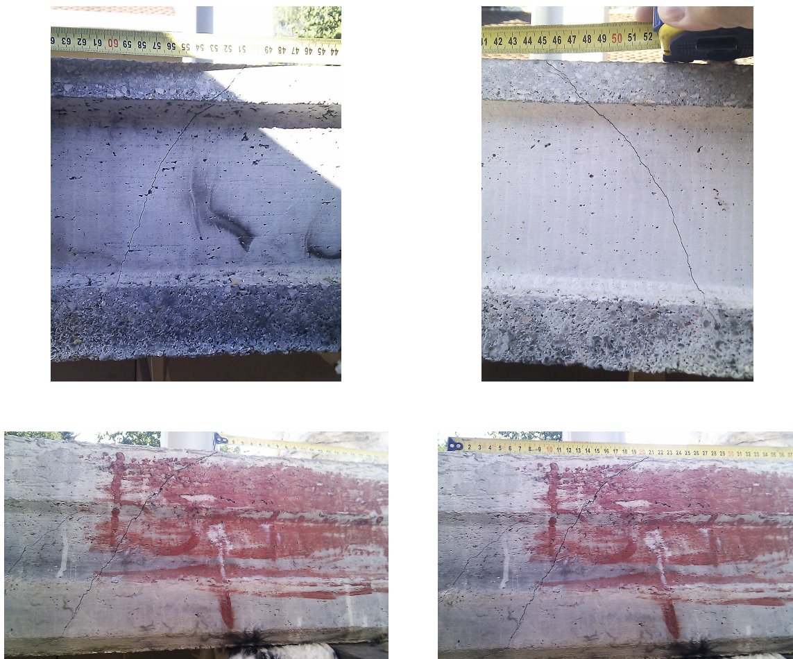
Fotografija 6.11. Prikaz kosih posmičnih pukotina na ležajevima ploče
