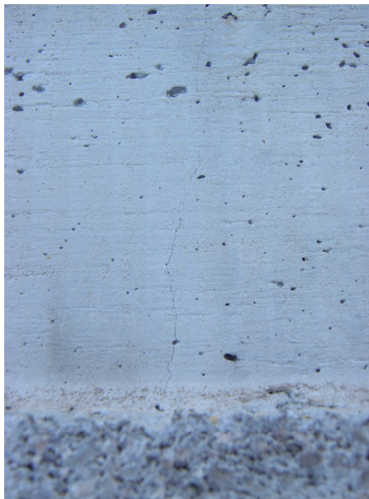
Fotografija 6.12. Prikaz vertikalne pukotine po dužini ploče
