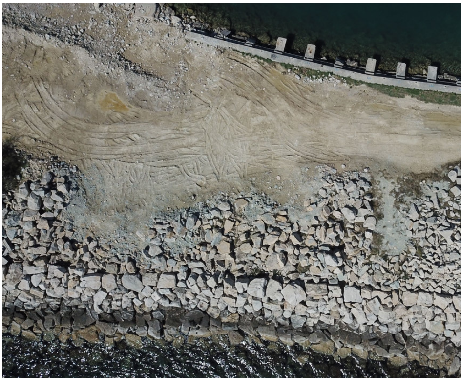
Slika 8.1.3. Postojeći lukobran s brojnim vidljivim oštećenjima
