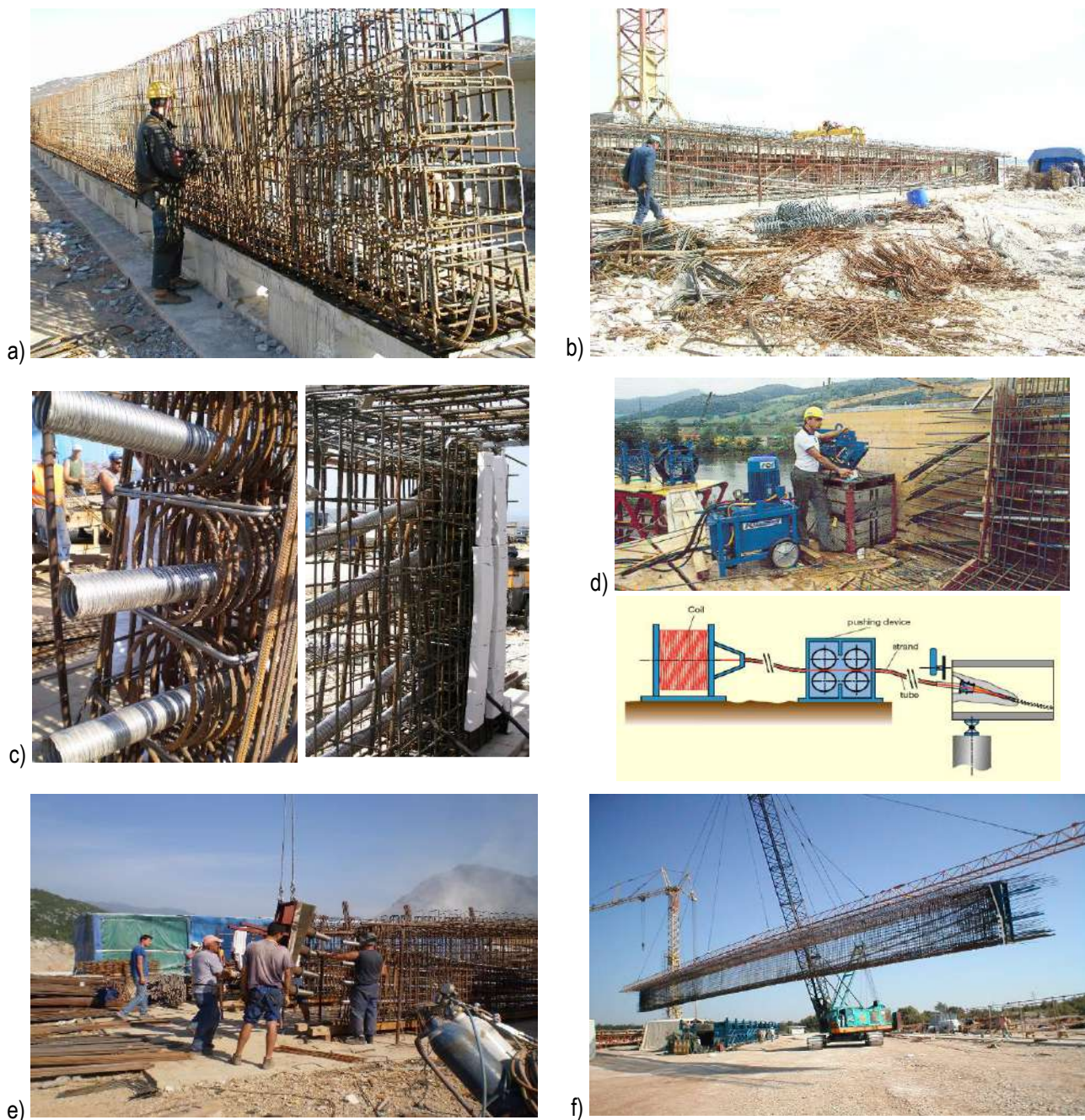
Slika 7.13 – Izvođenje naknadnog prednapinjanja nosača nekog mosta –postavljanje armaturnog koša i cijevi za provlačenje užadi
