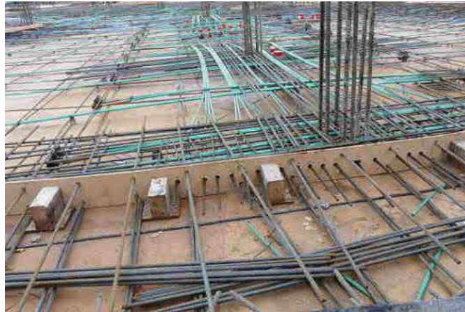
Slika 7.45 – Prednapeta monolitna ploča – postavljena armatura i „unbonded“ užad u PEHD cijevima (zeleno)
