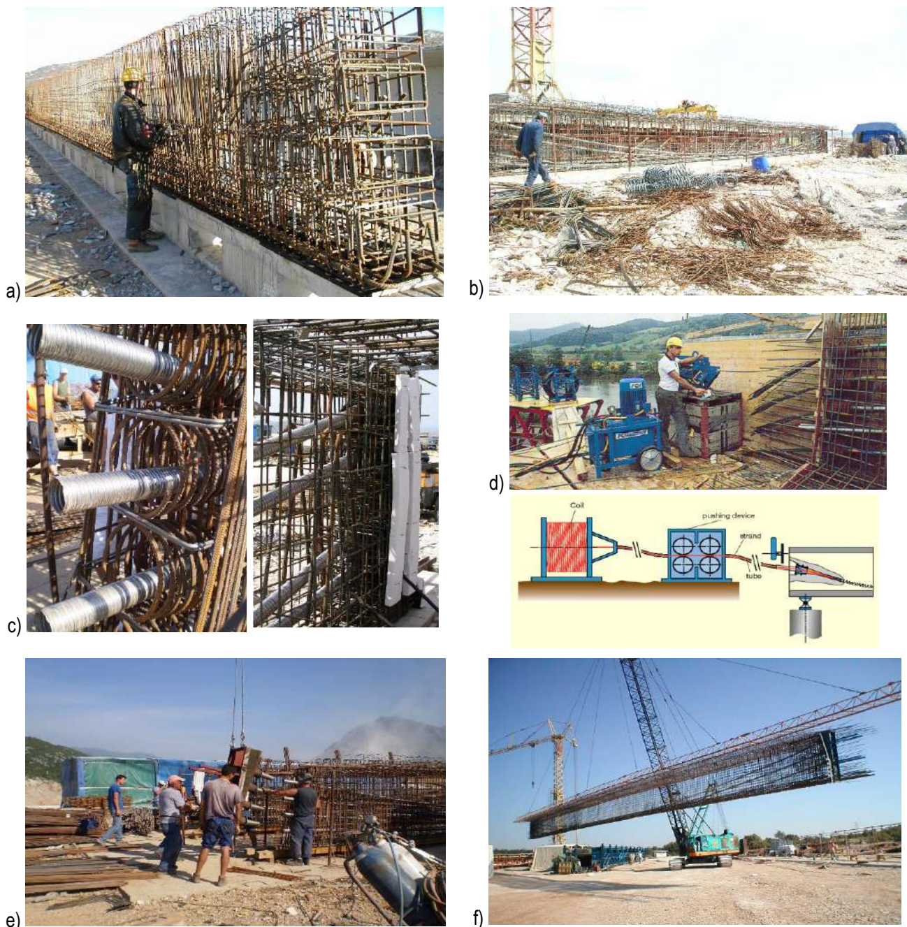
Slika 7.13 – Izvođenje naknadnog prednapinjanja nosača nekog mosta –postavljanje armaturnog koša i cijevi za provlačenje užadi
