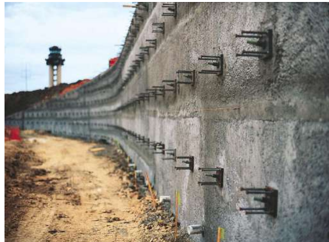
Slika 7.46 – Potporni zid u Dallasu, Fort Worth Aerodrom učvršćen Dywidag Soil Nails sidrima
