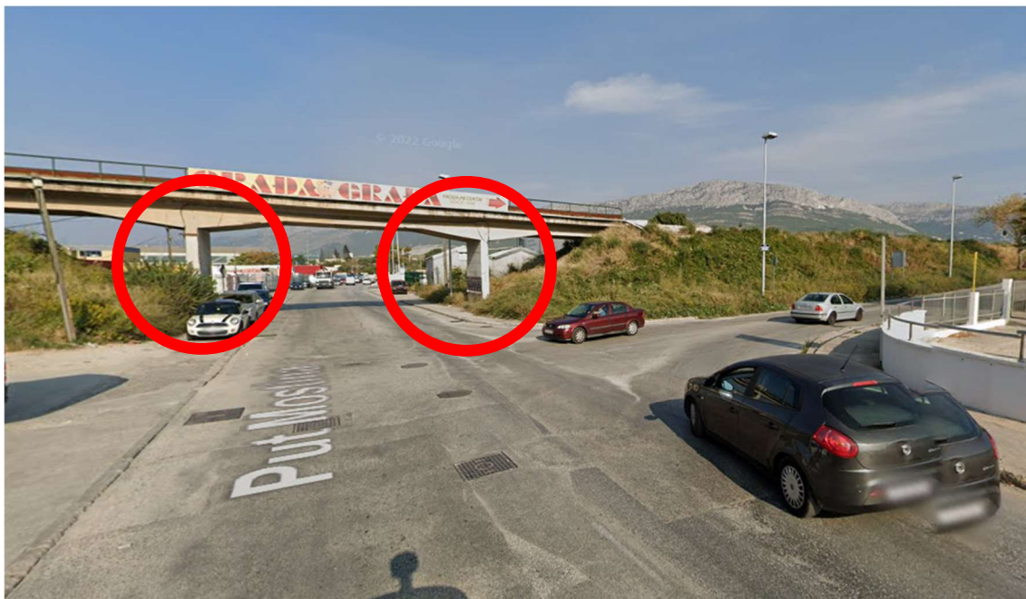
Slika 41. Problem željezničkog nadvožnjaka [2]
