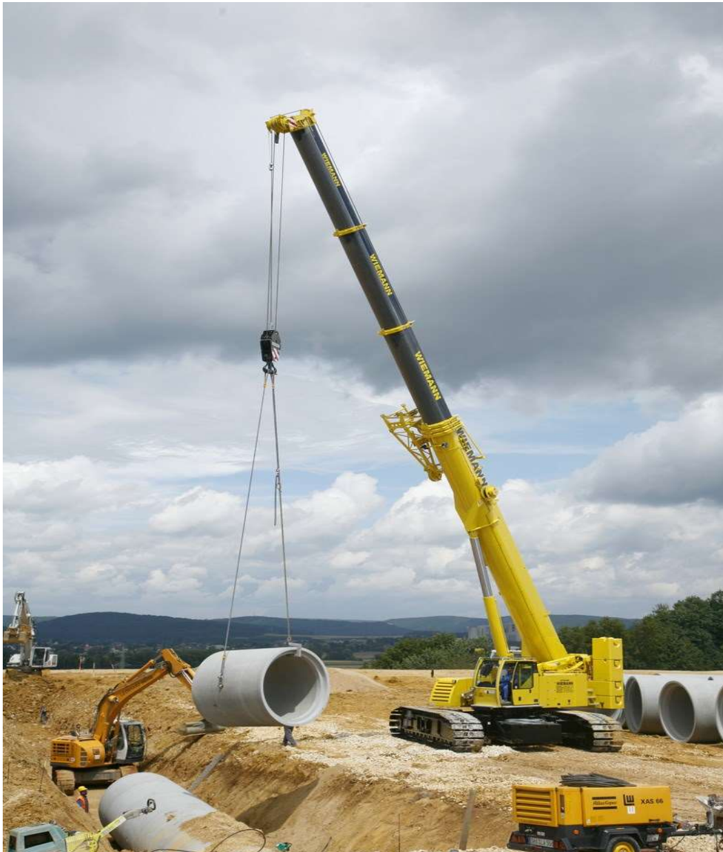
Slika 3.7 Auto dizalica Liebherr LTR 1100 [6]
