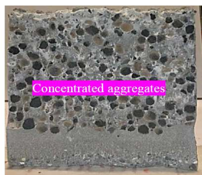
Slika 5.12: primjer segregacije po betonskom presjeku[17]
