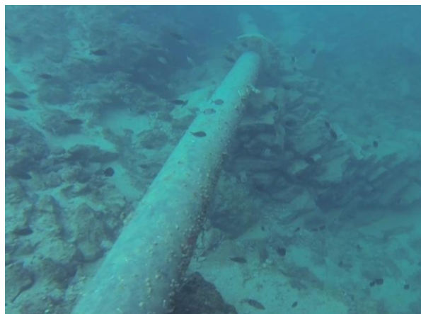
Slika 18. Vertikalni i horizontalni lom cjevovoda
