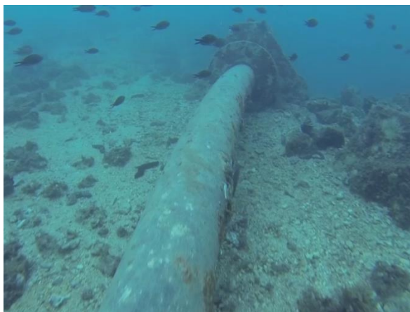
Slika 17. Vertikalni lom cjevovoda na ulazu u rov
