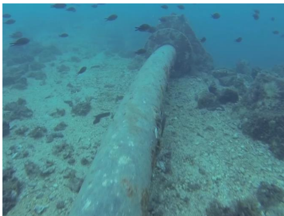
Slika 17. Vertikalni lom cjevovoda na ulazu u rov
