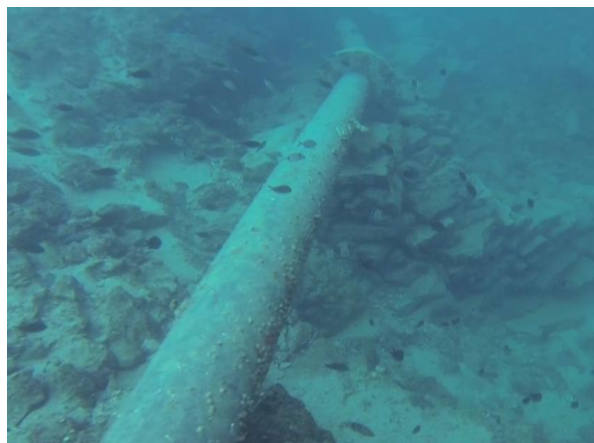
Slika 18. Vertikalni i horizontalni lom cjevovoda
