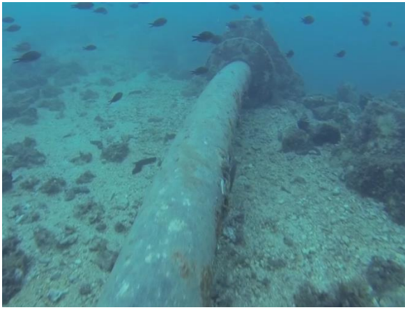
Slika 17. Vertikalni lom cjevovoda na ulazu u rov
