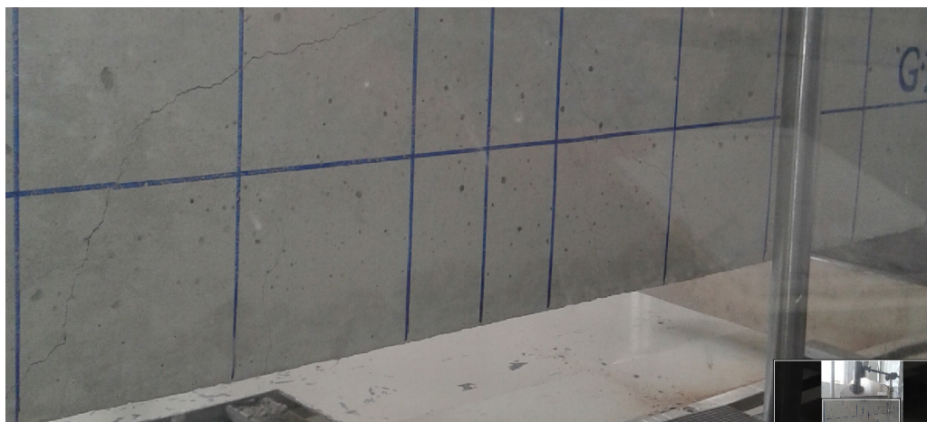
Fotografija 4.10 Širenje pukotina prije sloma na gredi G1
