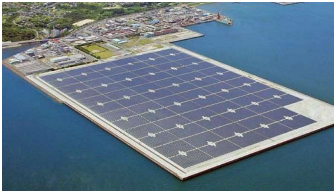
Slika 2.15 Mega solarna elektrana Kagoshima Nanatsujima [2]
