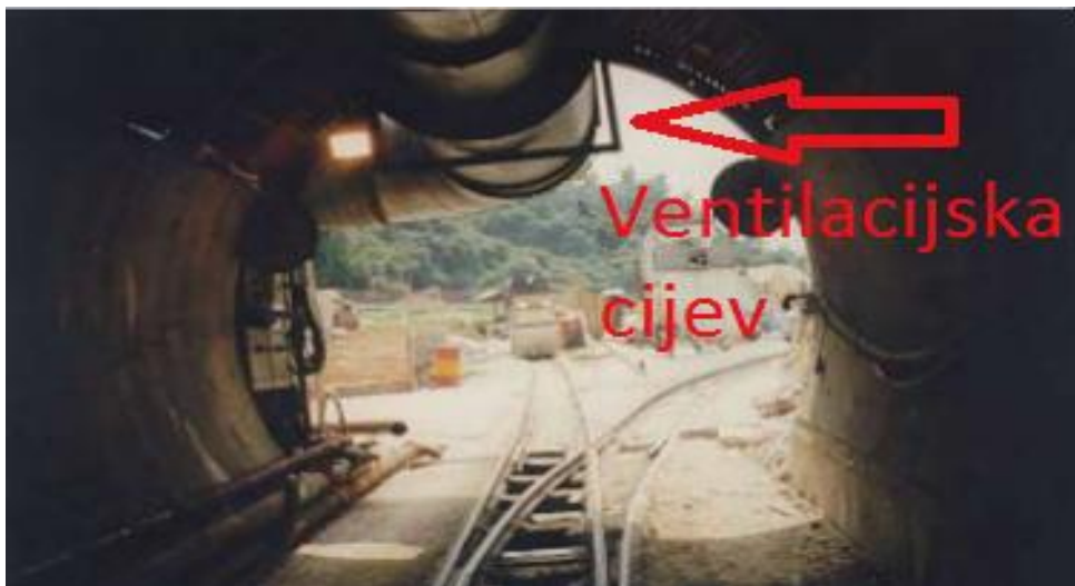
Slika 7-Prikaz ventilacijske cijevi u tunelu
