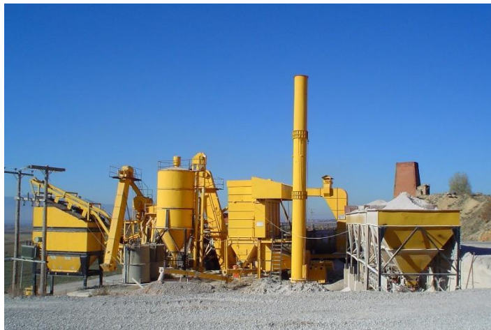
Slika 12 -Postrojenje za proizvodnju asfalta
