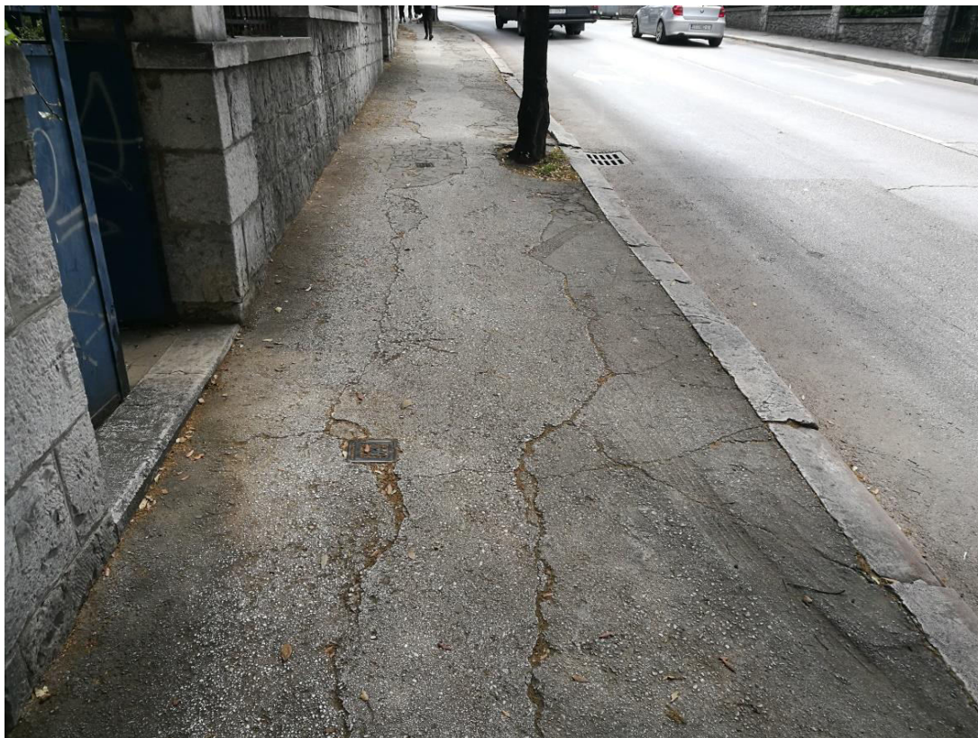
Slika 6. Vukovarska Ulica (oštećenja sjevernog pločnika)
