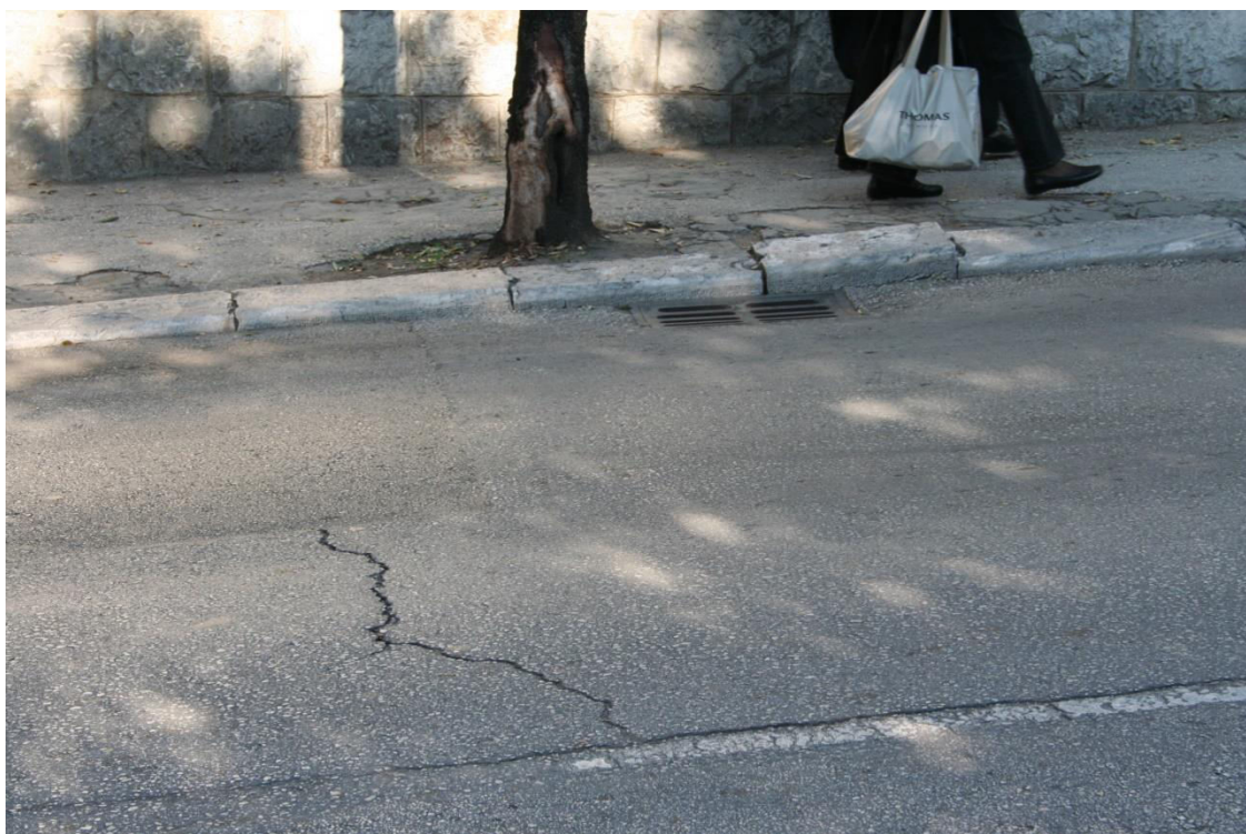
Slika 7. Vukovarska Ulica (oštećenja sjevernog rubnjaka)
