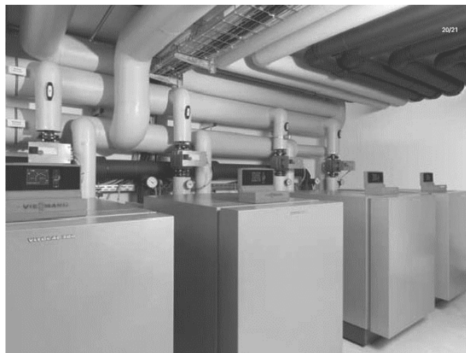
toplinske pumpe u podrumu
