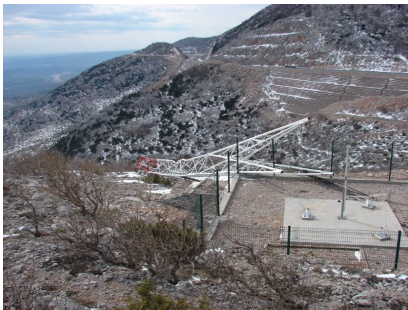
Slika 5.1 Srušeni antenski stup, Marune (južna padina Velebita, 2013)
