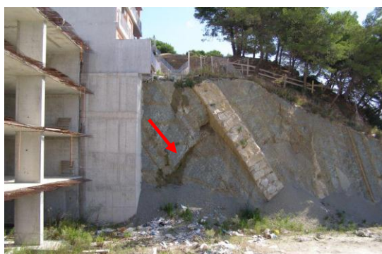
(c) 2006. (procjeđivanje kroz sekundarne pukotine)
