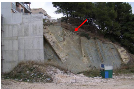
(g) 2012. (početak odrona po sekundarnoj pukotini)
