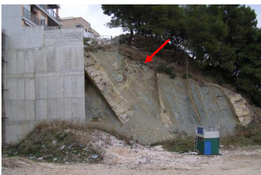
(g) 2012. (početak odrona po sekundarnoj pukotini)
