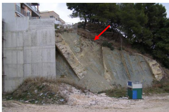
(g) 2012. (početak odrona po sekundarnoj pukotini)
