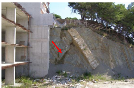
(c) 2006. (procjeđivanje kroz sekundarne pukotine)
