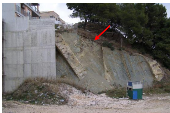
(g) 2012. (početak odrona po sekundarnoj pukotini)
